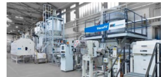
Die VacuFil-Testanlage am Firmensitz in Remscheid steht Kunden und Interessenten für Material- und Prozessprüfungen zur Verfügung © 2021 BBEngineering
