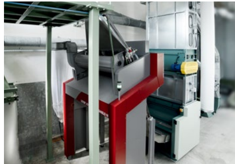
Instalación de UJVSN en la producción de telas no tejidas © 2022 USTER
